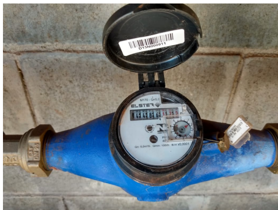
Foto hidrômetro FEC - Autoria Própria
