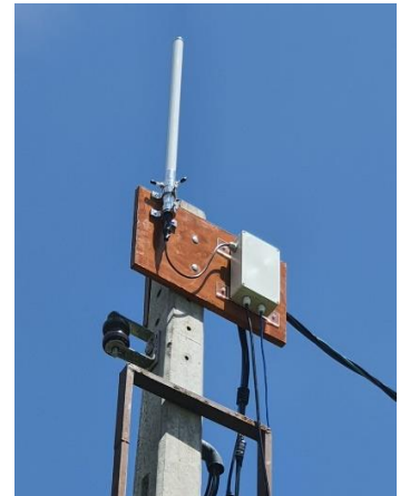
Figura 8 - Instalação do receptor no poste.
