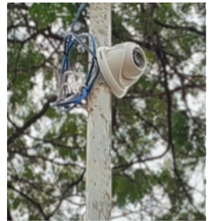
Figura 1 - Câmera Instalada – fonte: Coletânea do autor
