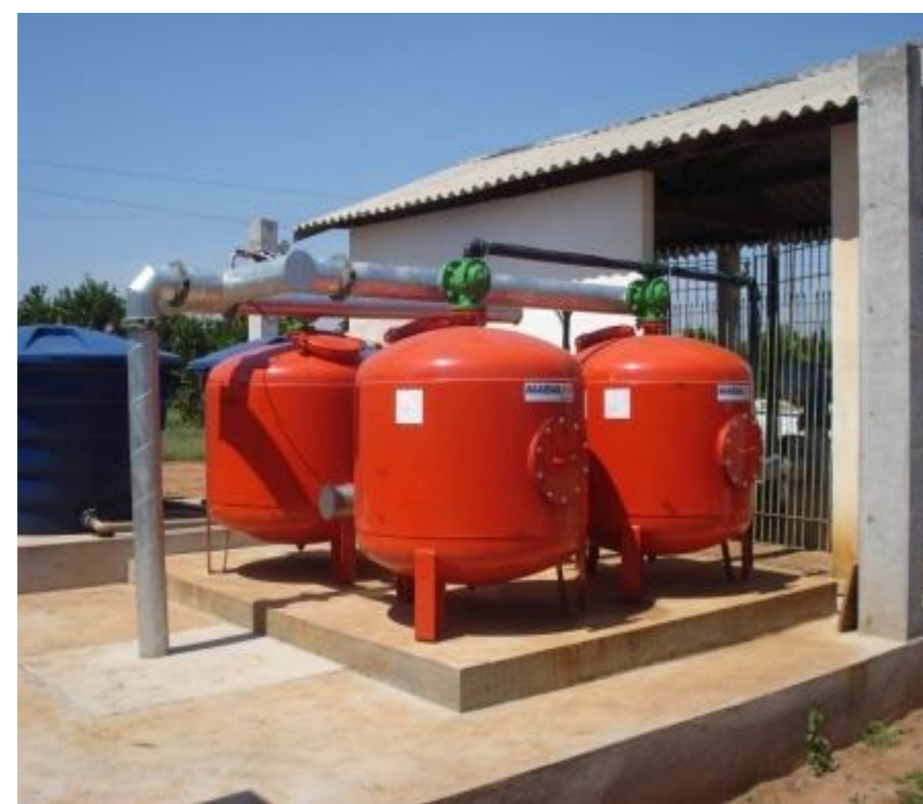
Figura 1: Filtros de areia
