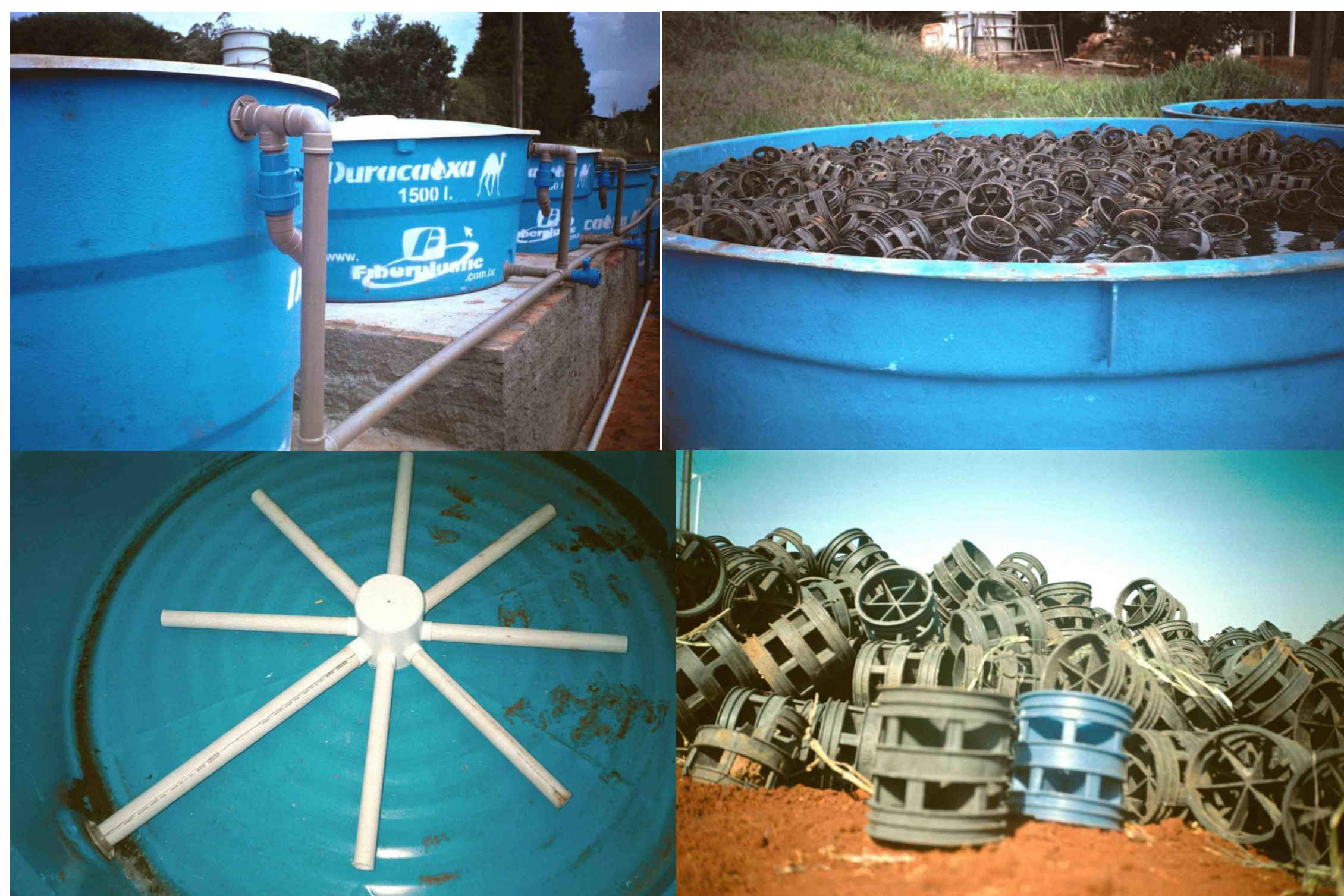
Figura 1. Sistema de distribuição do efluente nos reatores, de coleta de amostras e Meio Suporte (oring) utilizado como enchimento dos Filtros Anaeróbios.
