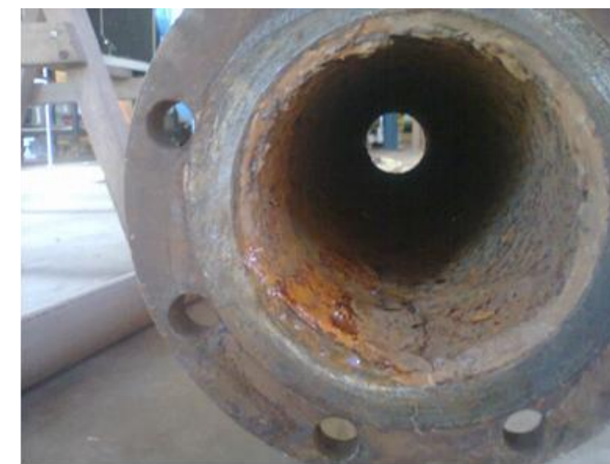
Figura 3 – Incrustações na tubulação
