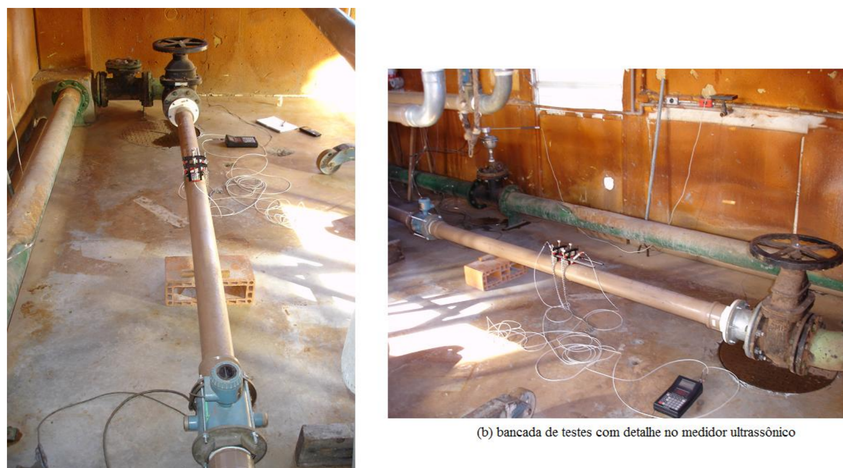
Figura 2 (a) e (b): Bancada de testes, evidenciando o posicionamento dos medidores.
