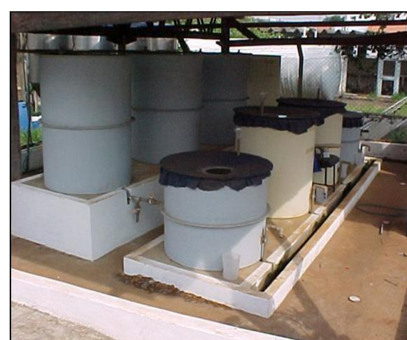
Figura 3: Visão externa dos filtros de areia.
