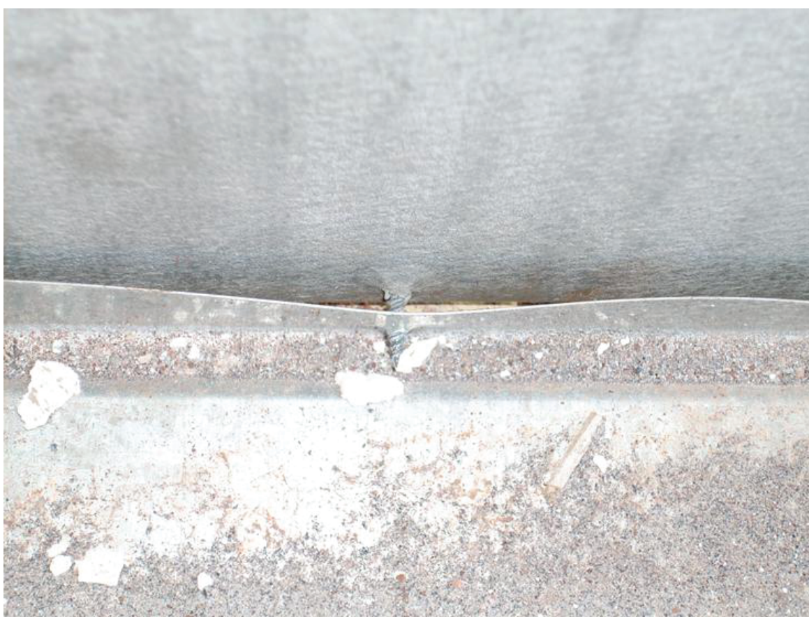
Figura 3 – Elemento de fixação colocado incorretamente deformando a guia Fonte: SAURO, 2009
