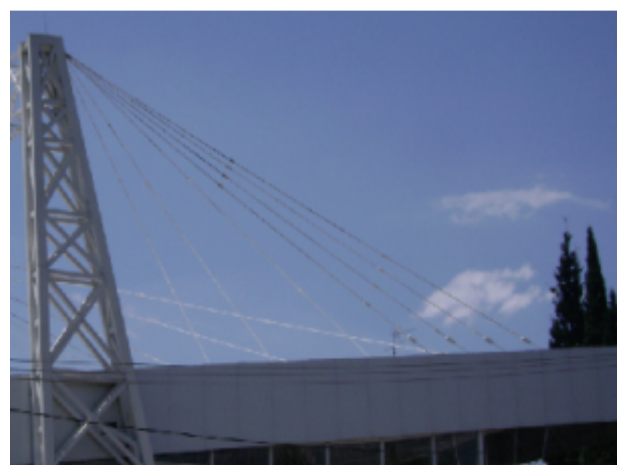
Figura 2: Cabos de aço com cerca de 20 metros de comprimento utilizados no suporte de uma cobertura na concessionária da Ford.
