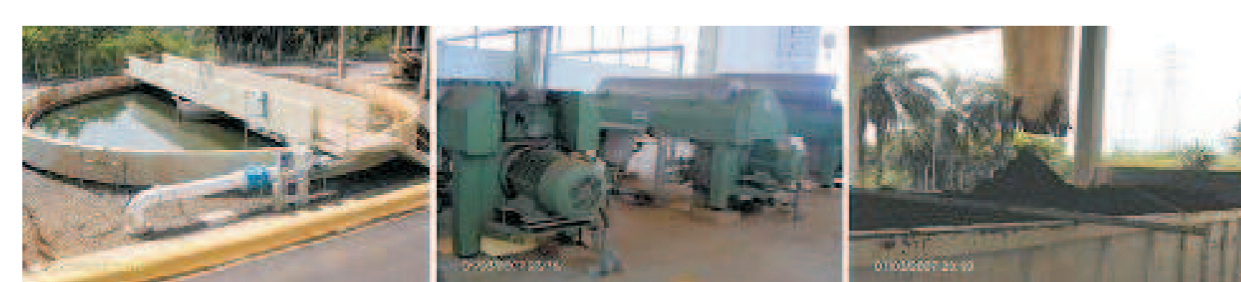
Figura 4. ETA-ETL SANASA: (A) - Adensador; (B) - Centrífuga; (C) – caçamba com lodo centrifugado.
