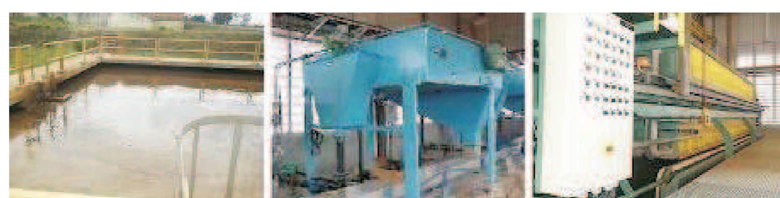
Figura 3. ETA-ETL Taiapuêba: (A) – Tanque de equalização; (B) – Mesa desaguadora; (C) – Filtro prensa de membrana.
