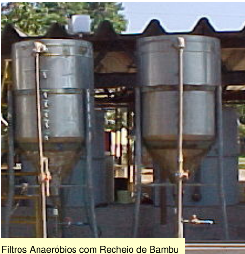
Filtros Anaeróbios com Recheio de Bambu
