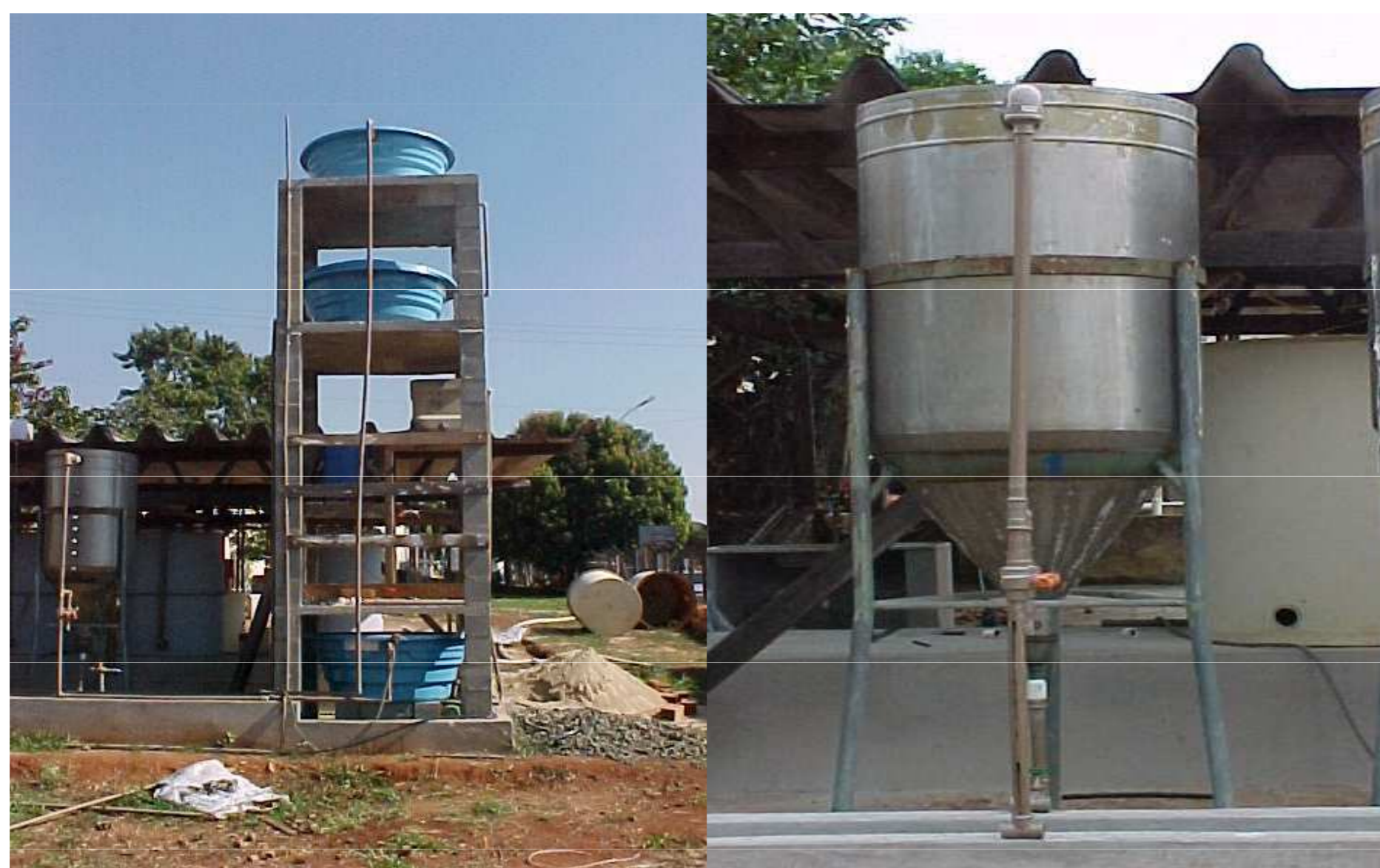
Caixas de armazenamento e distribuição de esgoto (à esquerda) e dos filtros anaeróbios com o coco como meio suporte.
