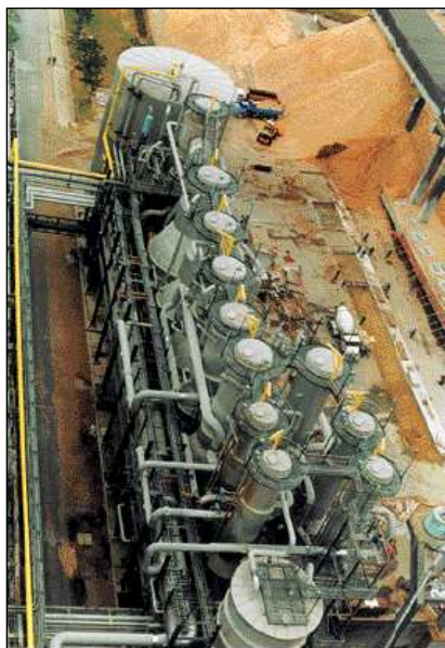
Figura 1 - Planta de evaporação de licor negro tipo falling film – capacidade 360 t/h.
