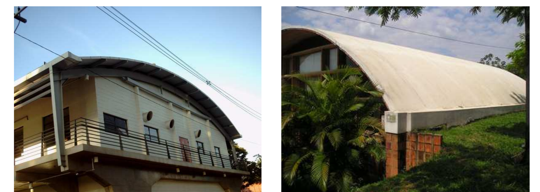
Figura 4 - (a) Arco parabólico no Instituto de Química. (b) Casca cilíndrica na Casa do Lago.
