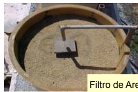
Interior do Filtro Anaeróbio
