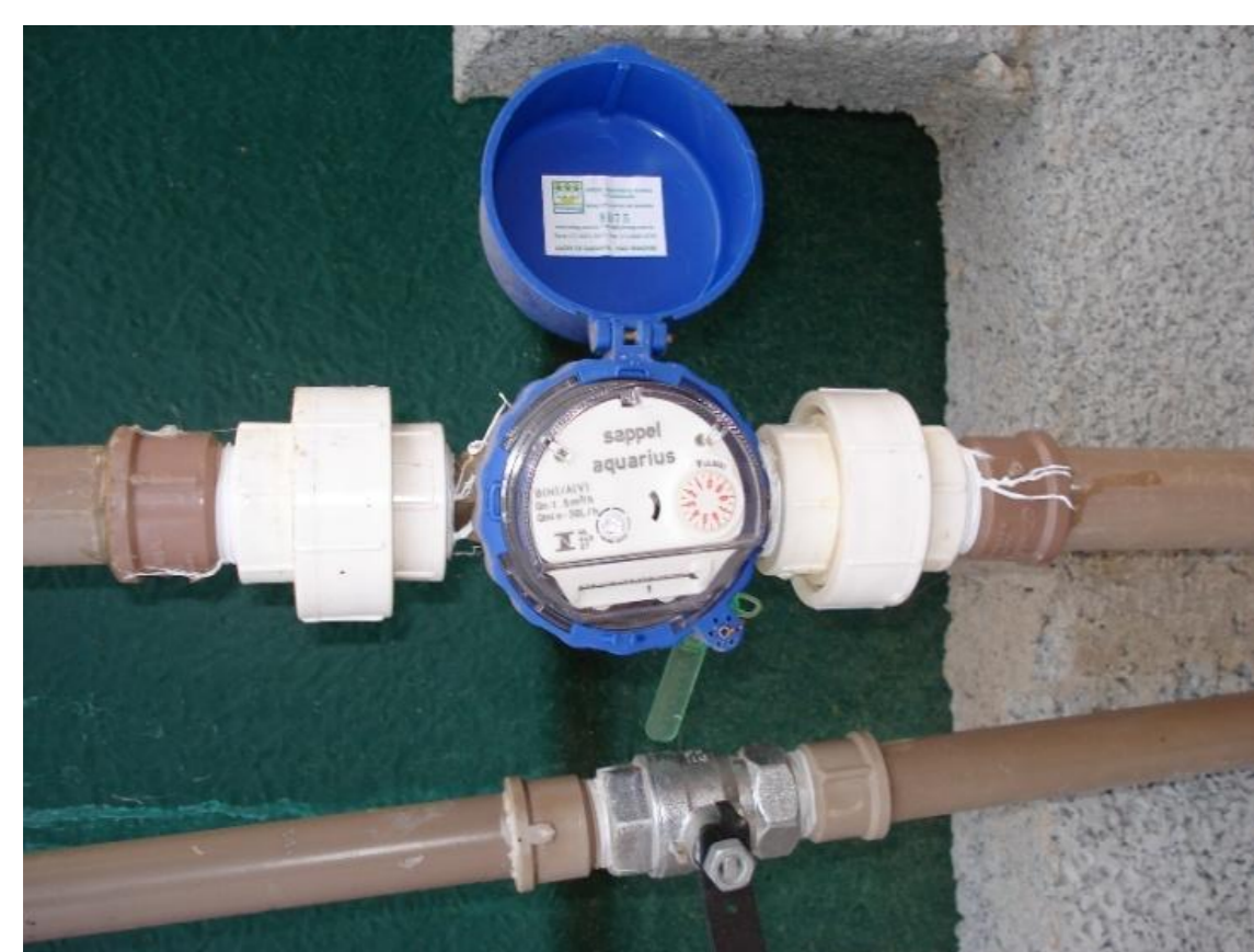
Figure 01: Hidrômetro para leitura de consumo de água.
