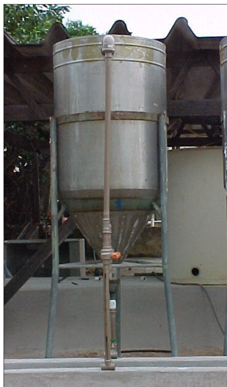
Fig 4: Vista externa do filtro anaeróbio
