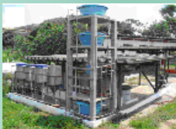
Figura 01: Vista geral do projeto instalado no LABPRO (fonte: TONETTI, 2008).
