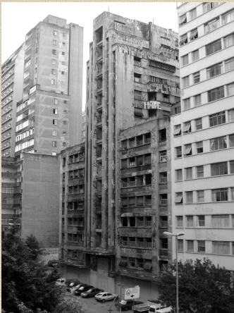
Prédio abandonado e lacrado no centro de São Paulo. Foto: Ennio Brauns, Dossiê Fórum Centro Vivo, 2006.
