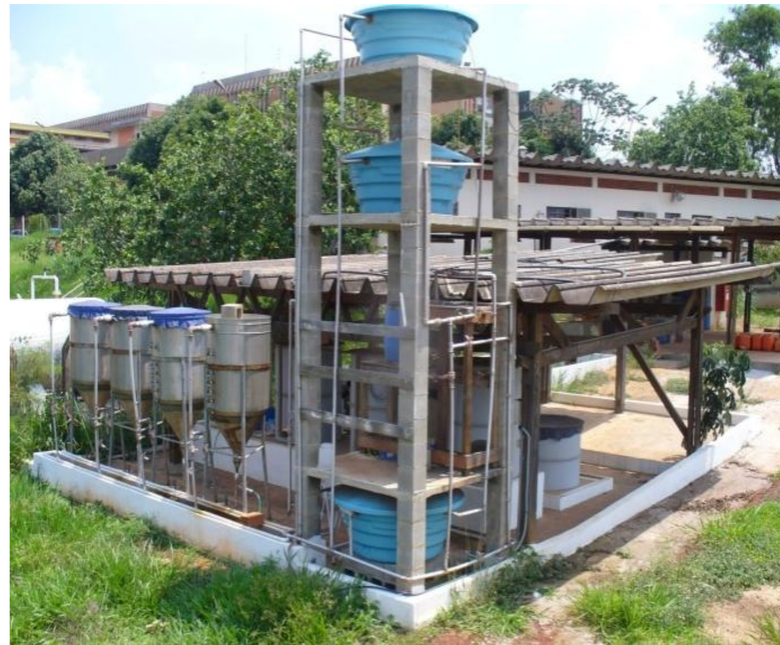
Figura 1: Vista dos reatores anaeróbios.
