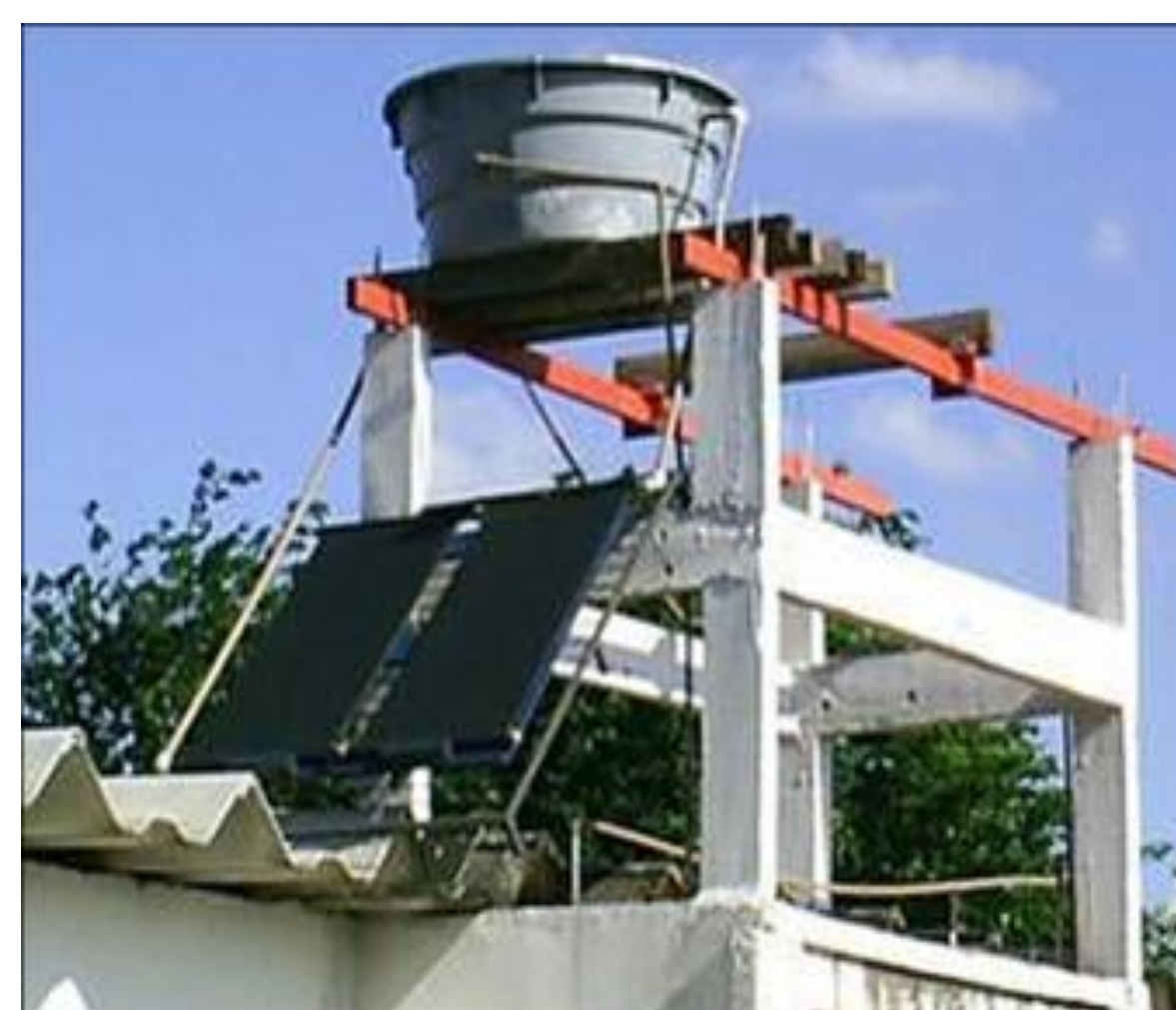
Figura 1. Sistema de CSBC instalado.
