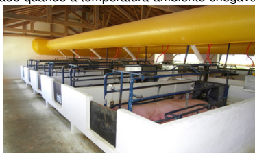
Figura 2: Linha de baias do galpão, sistema de resfriamento evaporativo (em amarelo) com saídas para cada baia.
