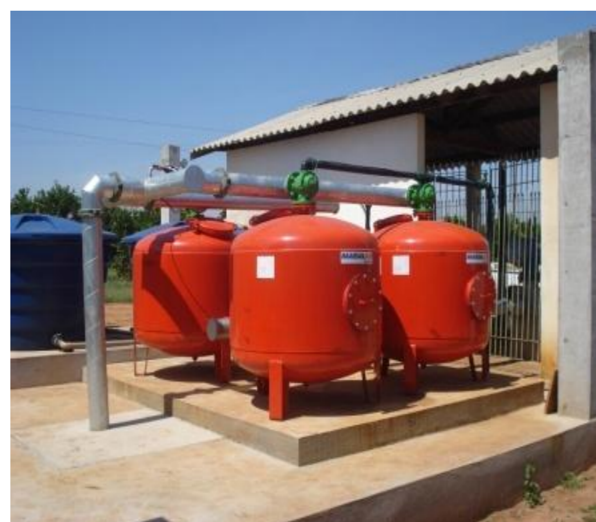
Figura 1: Filtros de areia
