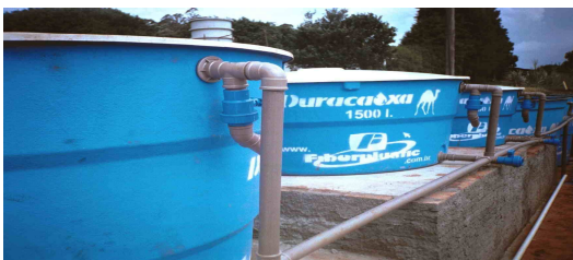
FIGURA 1. Foto do sistema modular (UASB/FA) instalado no campo experimental da FEAGRI/UNICAMP.
