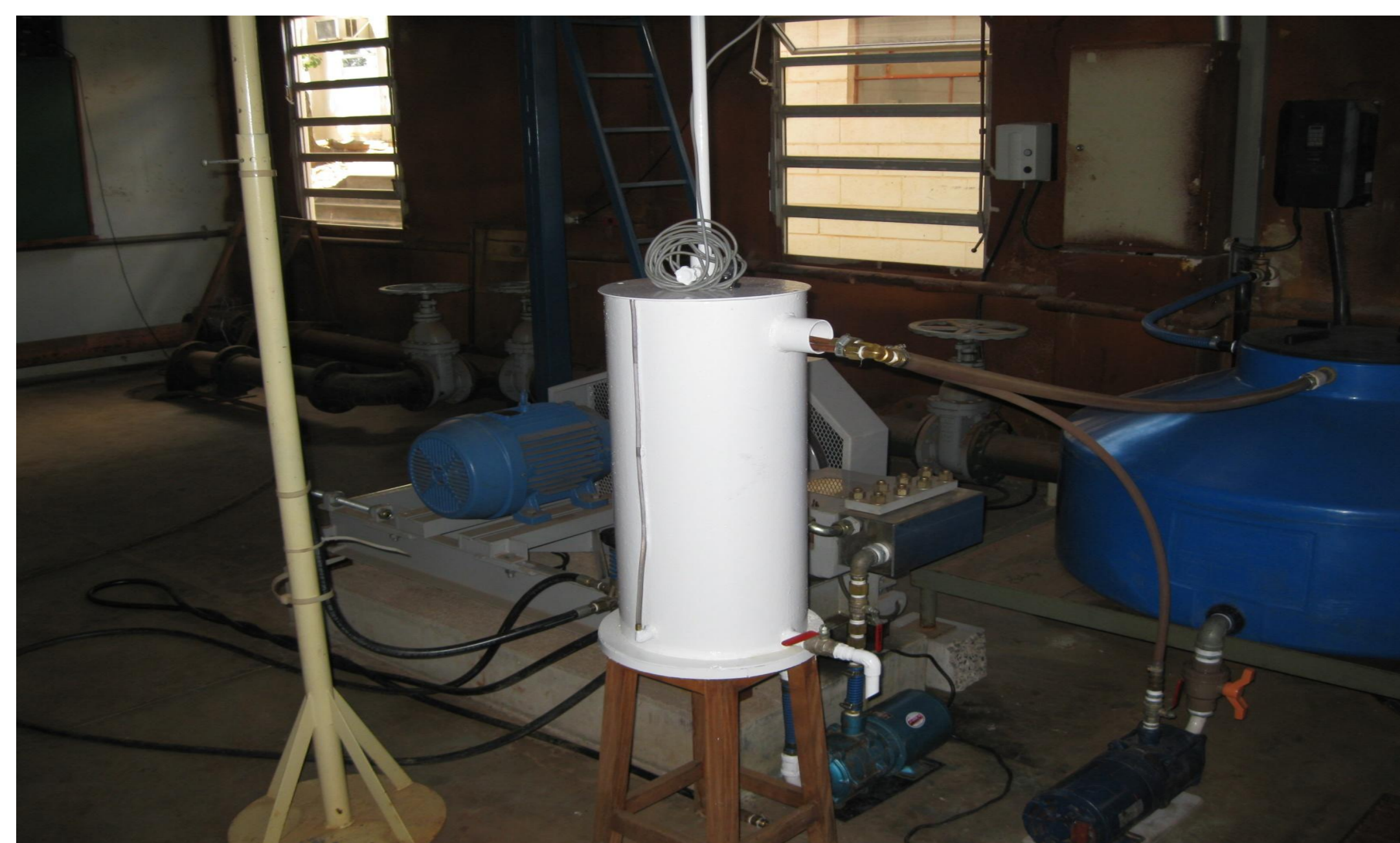
Figura 2. Unidade de Tratamento.
