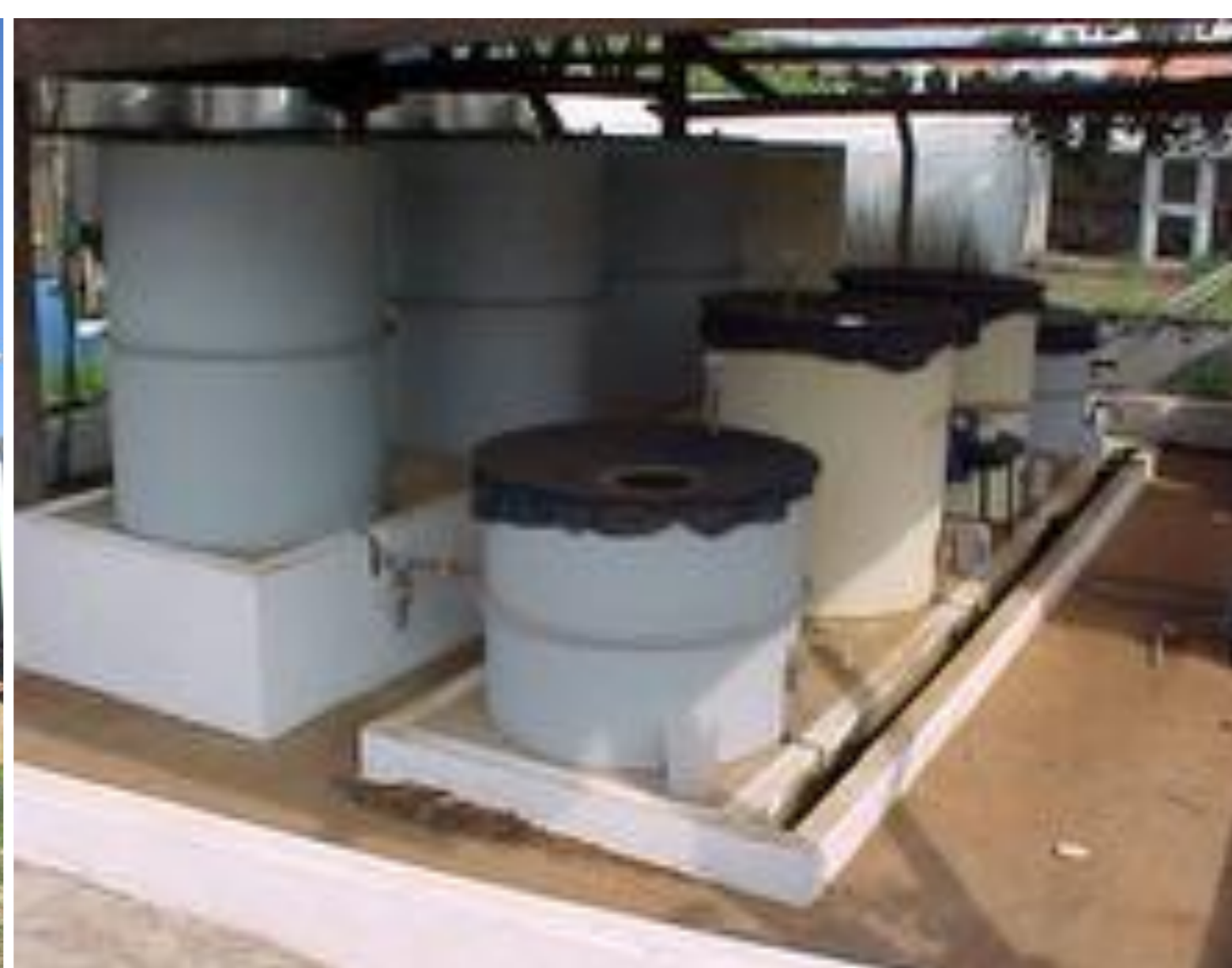
Tratamento de esgoto, composto por filtro anaeróbico com recheio de bambu associado a um filtro de areia e um reator de desnitrificação.
