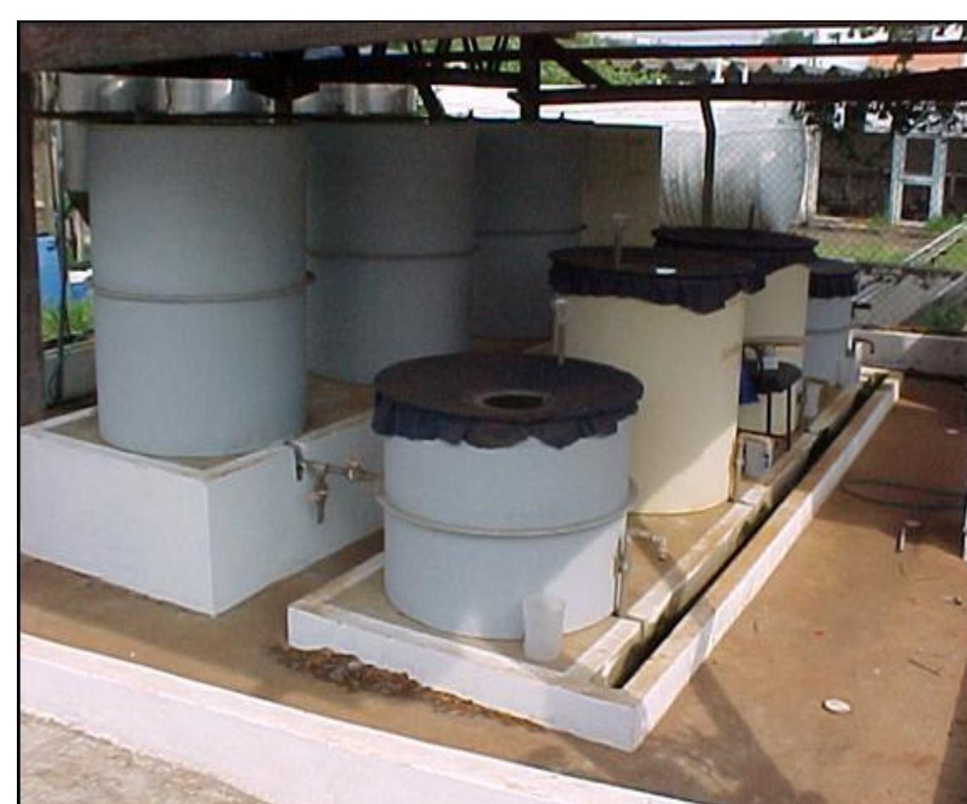
Figura 3: Visão externa dos filtros de areia.
