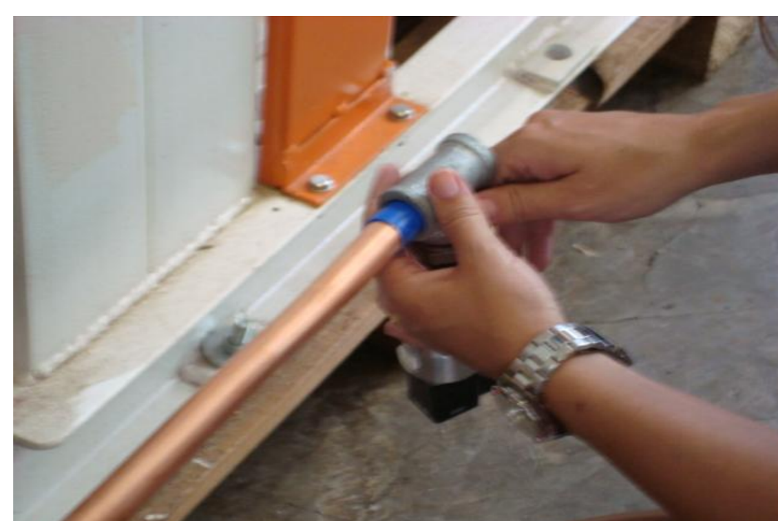
Figura 2: Instalação do sensor no sistema piloto.
