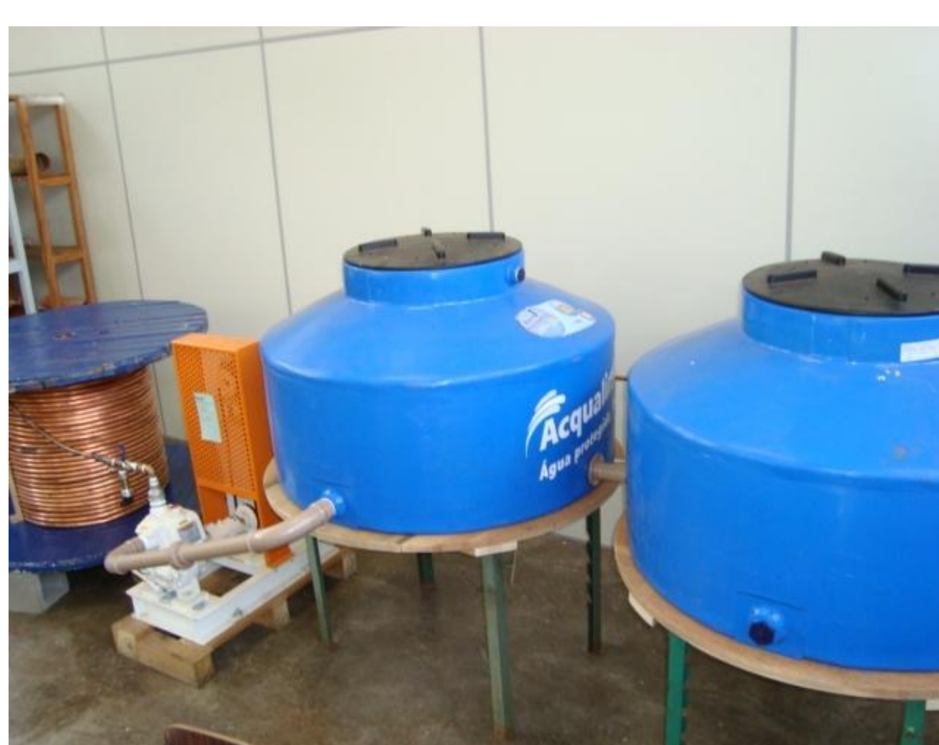
Figura 6: Piloto em funcionamento.
