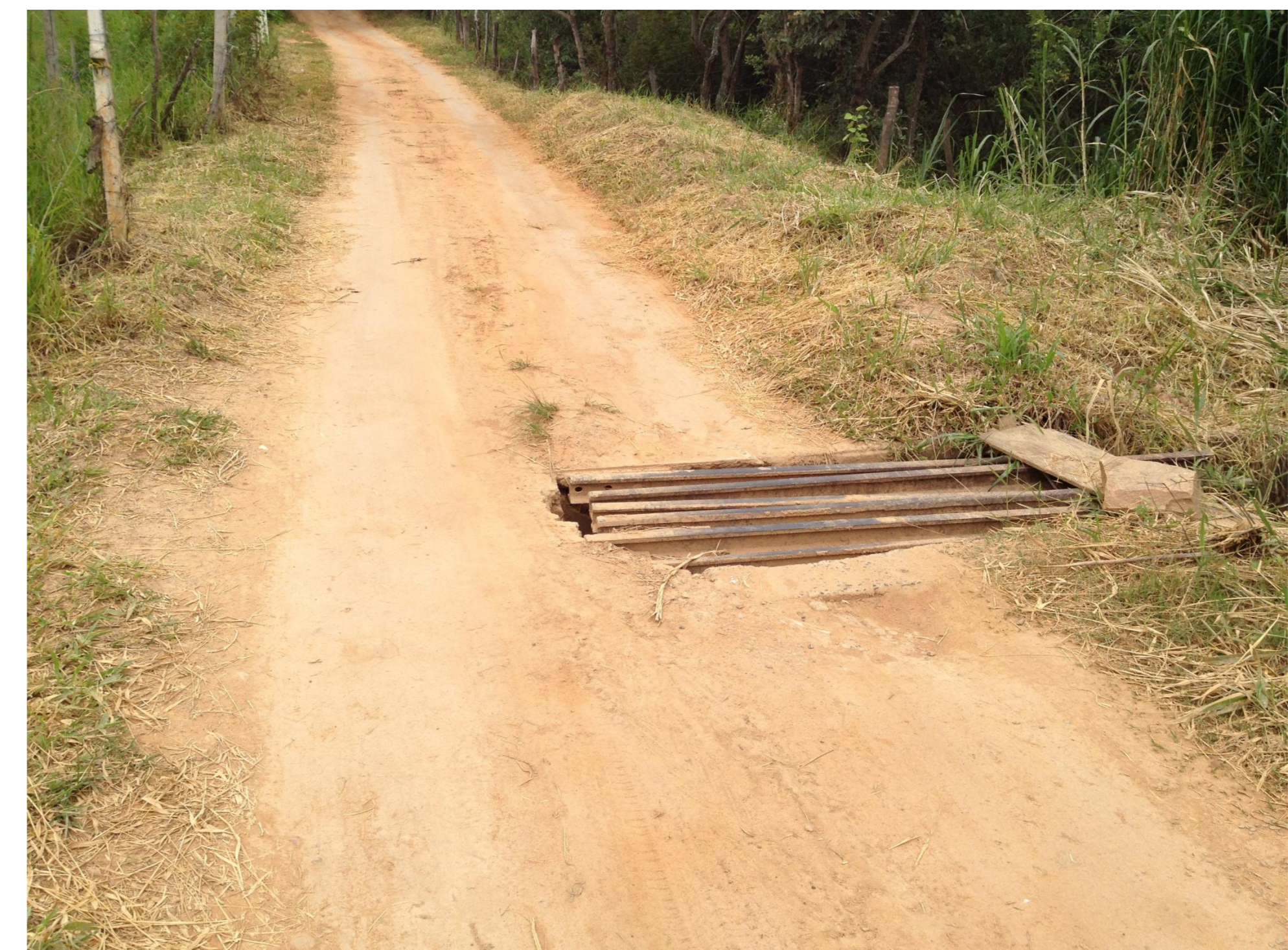
Figura 4: Defeito encontrado - Barragem desestruturada.
