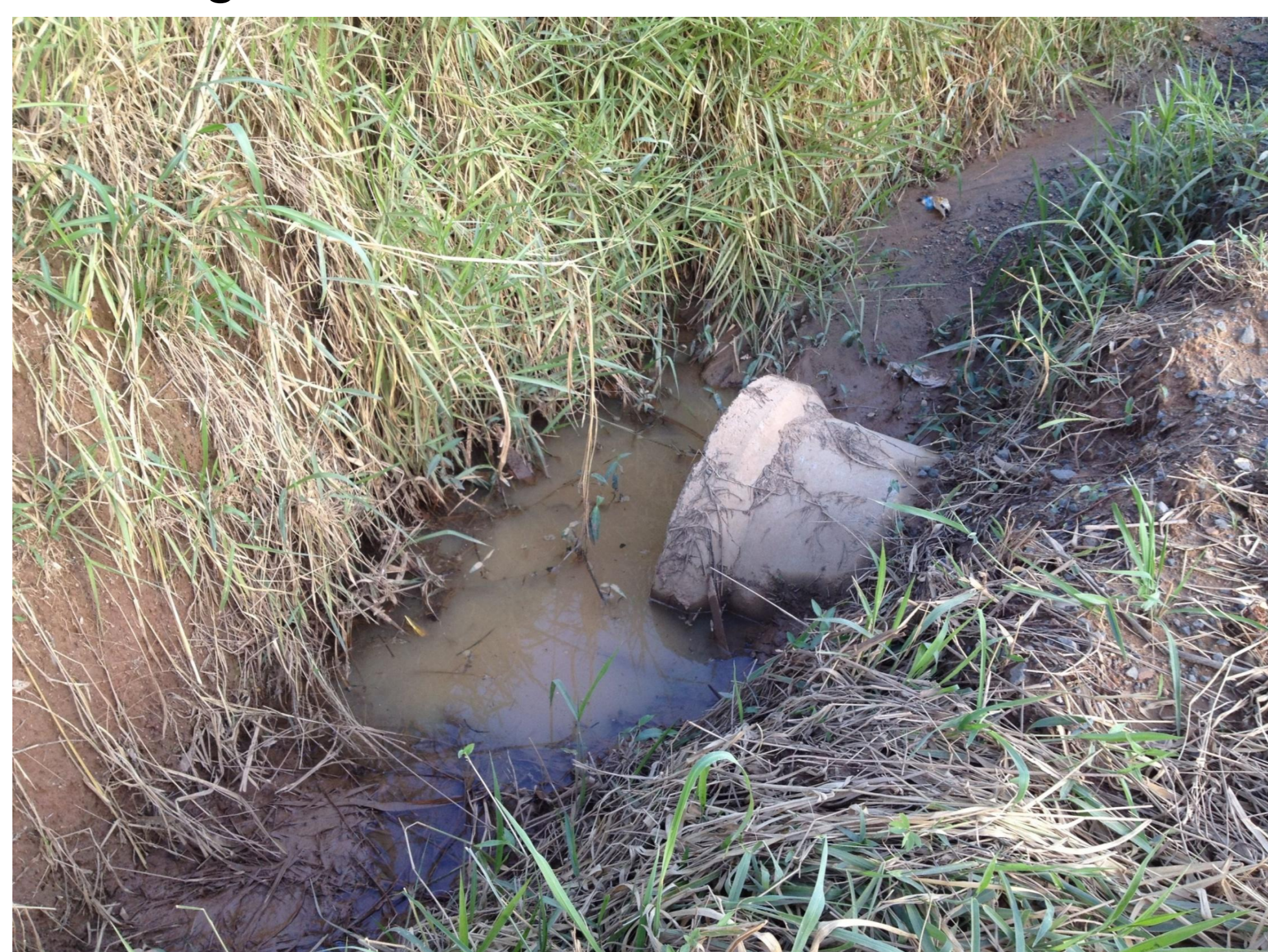
Figura 3: Defeito encontrado - assoreamento em bueiros.
