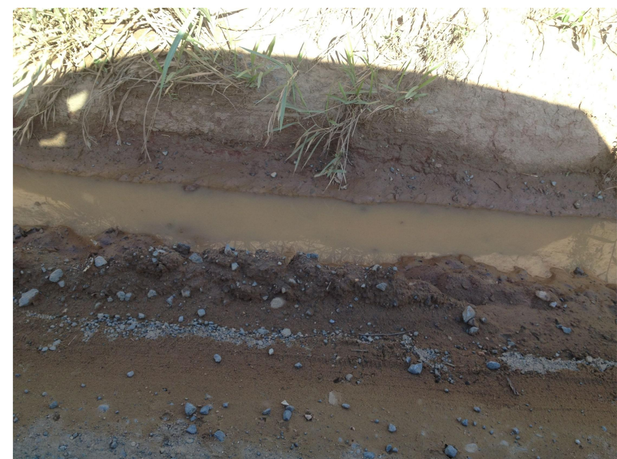
Figura 5: Defeito encontrado – Água parada sob a plataforma.
