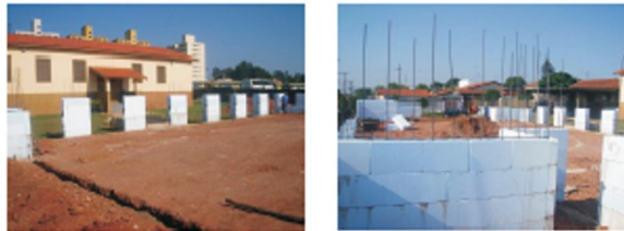
Figura 3 – Início da obra e elevação das paredes com o Iso-Bloco Fonte: Isocret do Brasil
